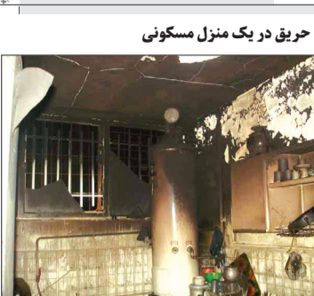
حریق در یک منزل مسکونی
